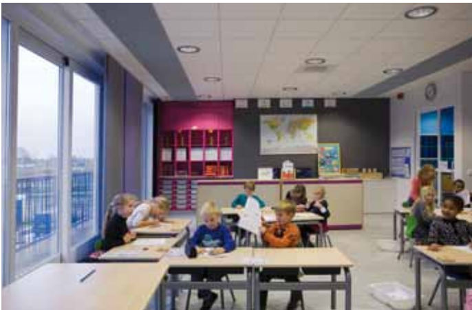
Voor het ventilatiesysteem van MFA Keijzershof zijn langs gevel en gangzone roosterstroken aangebracht in het plafond.
